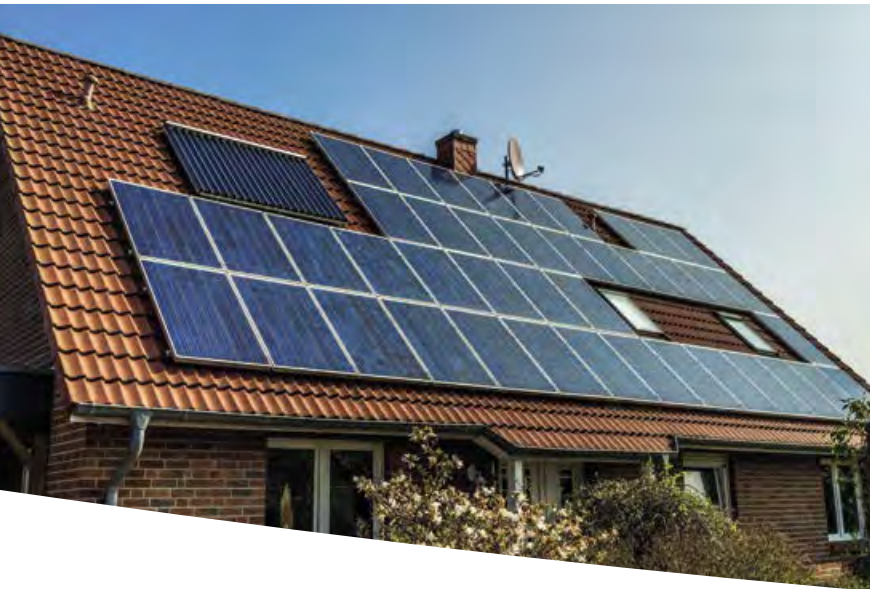
PV-Strom vom Dach selbst nutzen und Geld sparen
